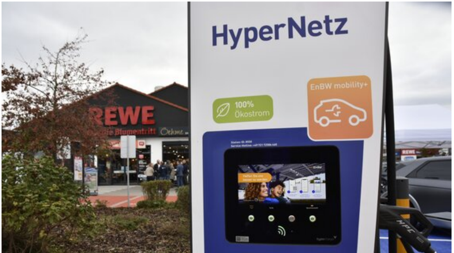
Schnelladesäule am REWE-Markt in Meerbusch-Büderich (Foto: Achim Bachhausen)
